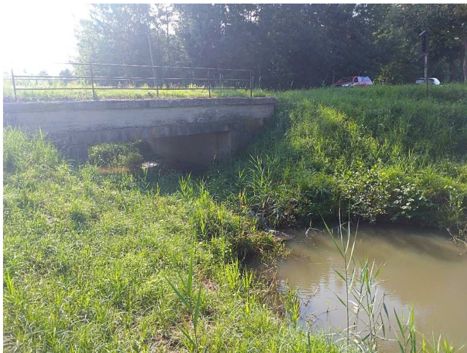
Foto č. 1 – Most u obce Černín, vytvořená tůň pod stabilizačním stupněm
